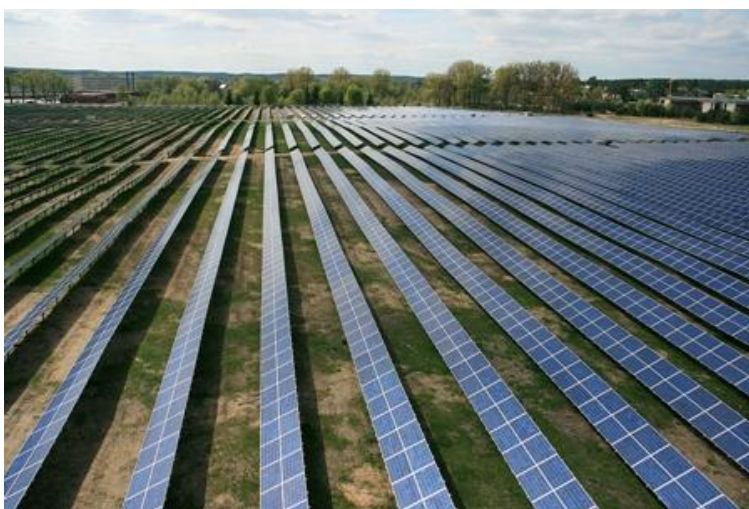
Parco solare IBC SOLAR da 8 megawatt a Neustrelitz
